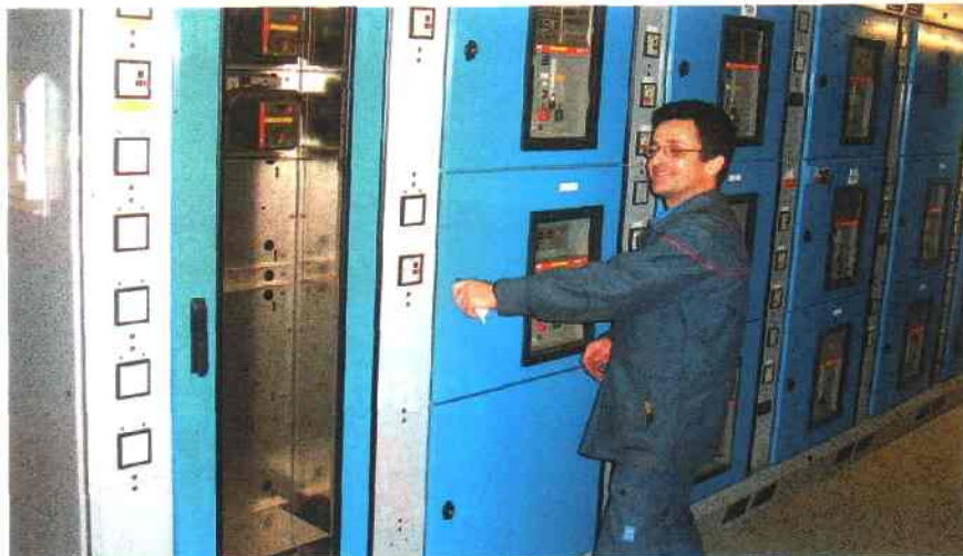
Dans les sous-sols sont notamment logés 6 postes de livraison et de transformation et 3TGBT.
