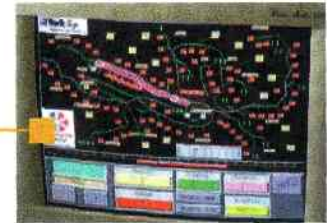
Usine à neige : la salle de contrôle avec son superviseur central.
